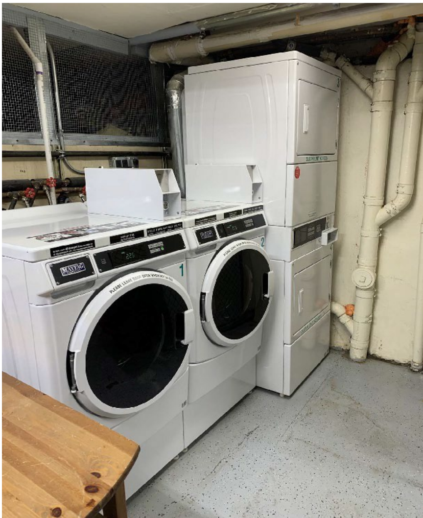
Tenant Laundry Room
