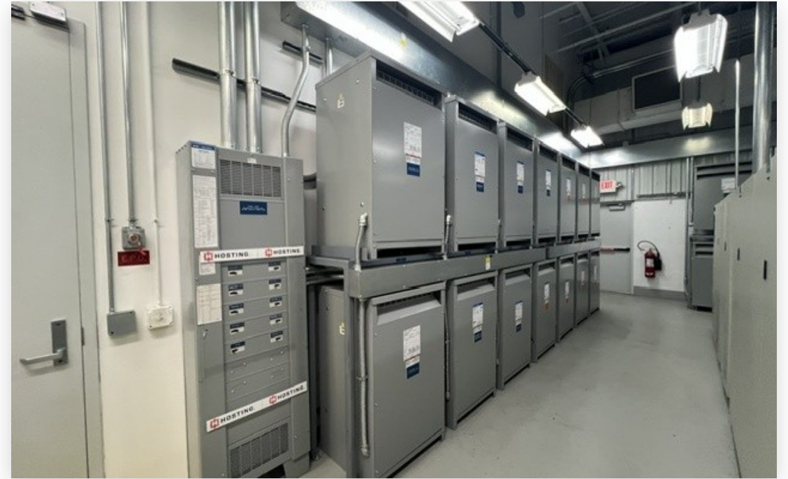
UPS plant: 500 kVA modules
