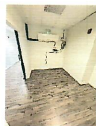
Mini Split server room
